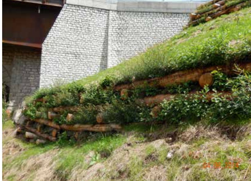
Opera strutturale in legname vegetata con talee e materiale da seme prodotto in vivaio. Versante Rio Sies Casez
