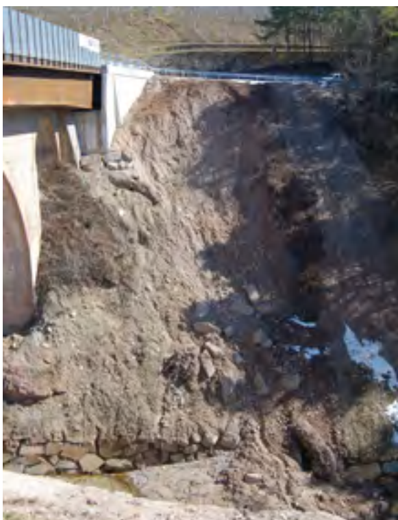
Area del dissesto sulla sponda del Rio Sies, in prossimità del ponte di Casez, lungo la provinciale di Dambel
