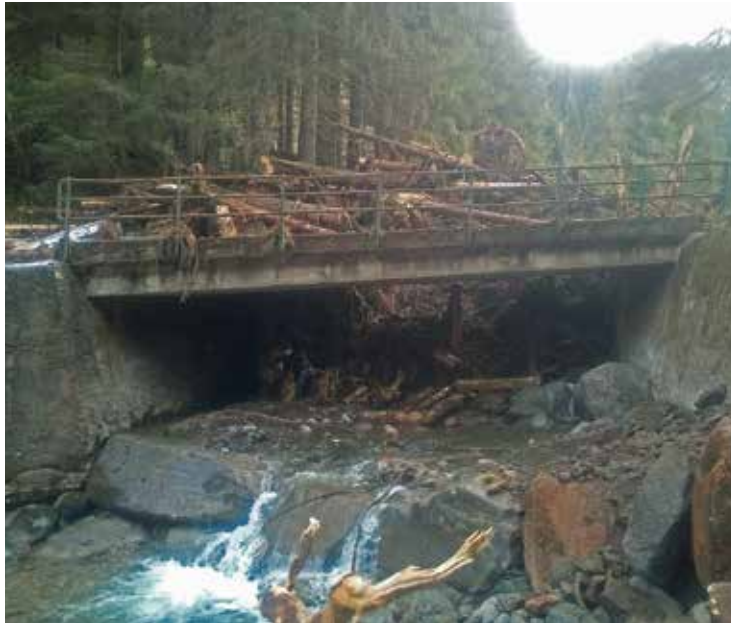
Vista da valle con accumulo di materiale a monte
