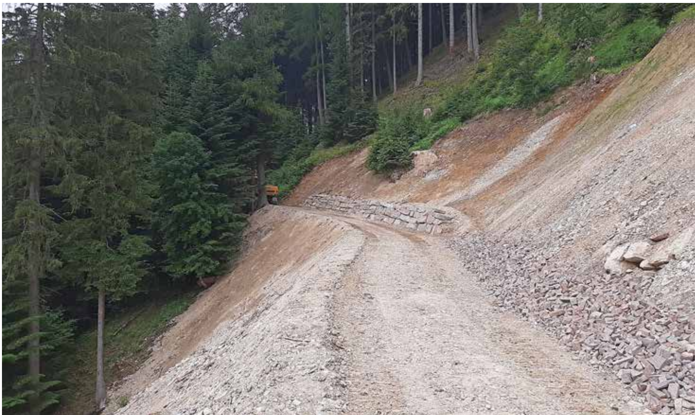
Ripristino cedimento strada con gabbioni metallici a valle e scogliera a monte
