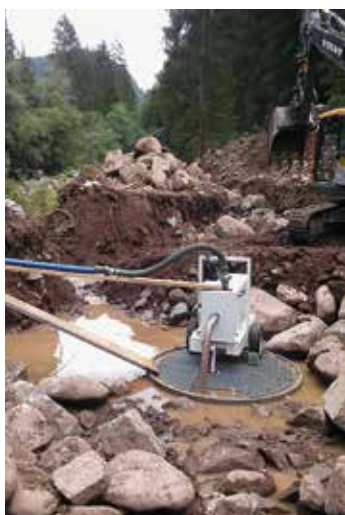
Pozzo di captazione
