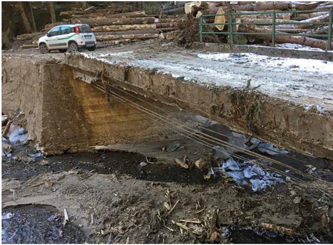
Ponte danneggiato verso monte
