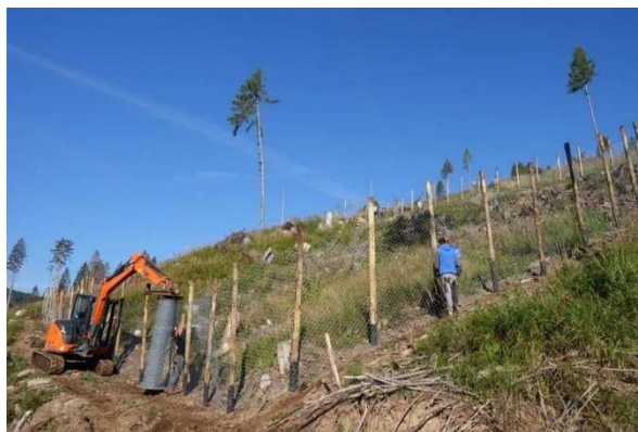
Figura 35 - Realizzazione di recinzioni per la protezione dal cervo dei rimboschimenti in località Bocche, F.D. di Paneveggio
