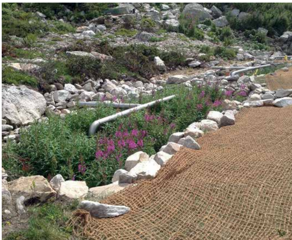
fitodepurazione in ambiente alpino, Parco naturale del Marguareis, 2014 - http://fitodep.parcomarguareis.it
