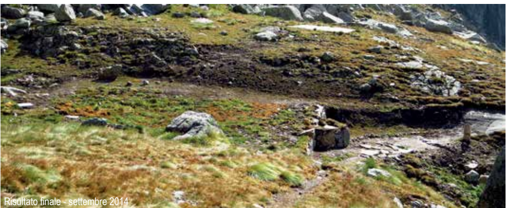
costruzione impianto di fitodepurazione, rifugio Tonolini, comune di Sonico, 2013/2014 - foto Paolo Negri
