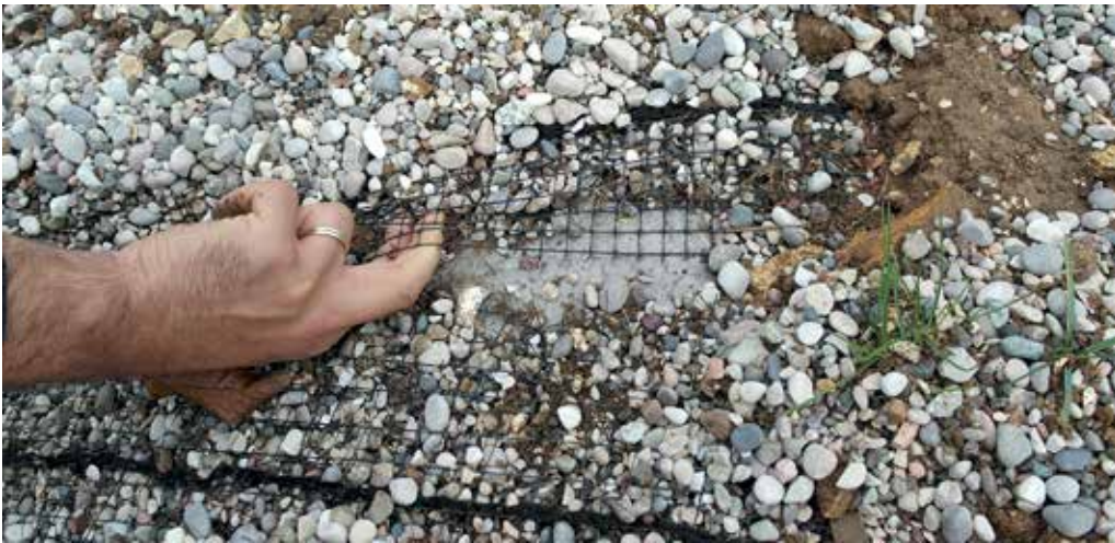
pozza serbatoio: geogrid per la trattenuta del materiale inerte, 2014 - foto Giovanni Giovannini
