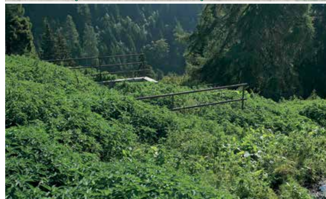
Vasca di stoccaggio delle acque di lavaggio dello stallone danneggiata. Di conseguenza lo smaltimento avviene in maniera incontrollata. Die Speicherwanne für Waschwasser aus dem Stall ist beschädigt. Dadurch erfolgt die Beseitigung unkontrolliert.
