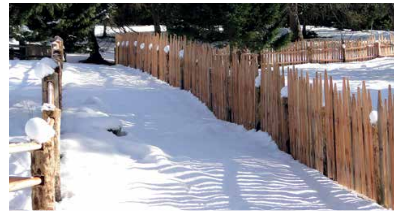
Realizzazione di recinzione in legno a malga Zuol, Coredò, Val di Non, 2014 - foto Carmelo Anderle. Nello specifico è stato realizzato un recinto per le capre con il tipo "steconata inchiodata" mentre il pascolo è stato delimitato da una recinzione del tipo "sailzaun di stanghe". Il corridoio fra le due recinzioni serve a indirizzare gli animali al pascolo su un'unica via. Errichtung eines Holzsauns auf der Zuol-Alm, Nonstal. Die Koppel für die Ziegen wurde mit genageltem Speltenzaun, die Weide mit einem "Salizaun di stanghe" begrenzt. Der Korridor zwischen den beiden Einfriedungen dient dazu, das Vieh auf demselben Weg zur Weide zu führen.
