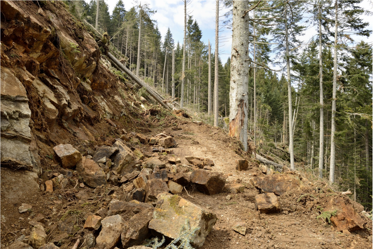
Foto 13: Strada danneggiata in Val Cavelonte (di Alessandro Gadotti)
