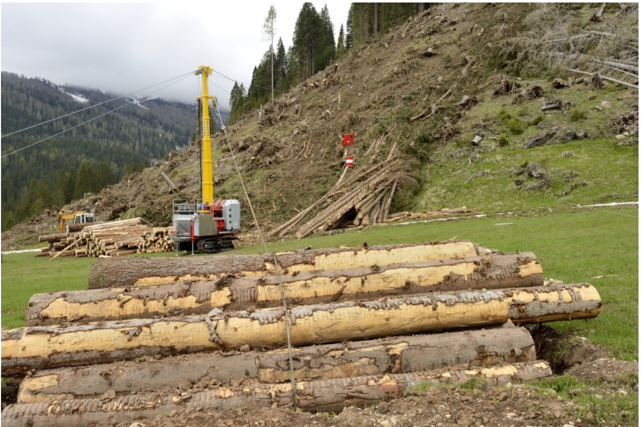
Fig 5.5 Particolare di un ancoraggio della controventatura di una gru a cavo (fonte: Alessandro Gadotti).
